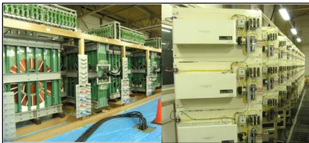
【図4】 電力系統シミュレータを構成する設備群である 66 kV 模擬送電線と PV 用パワーコンディショナー (PCS)
