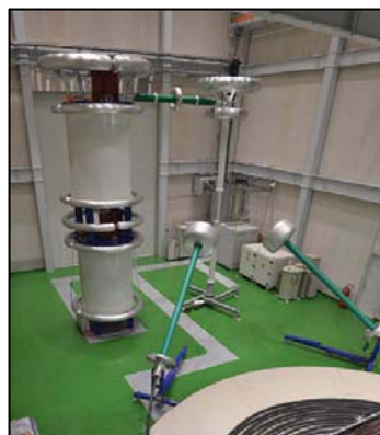
【図5】 CV ケーブル残存耐電圧 性能評価に活用する 絶縁特性試験設備
