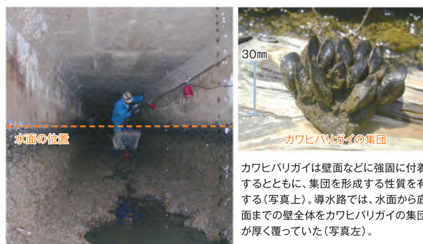
図2-9 導水路壁面に付着したカワヒバリガイ
