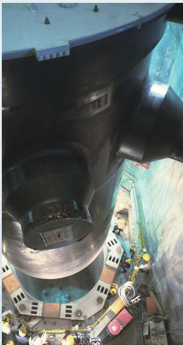
原子炉圧力容器
