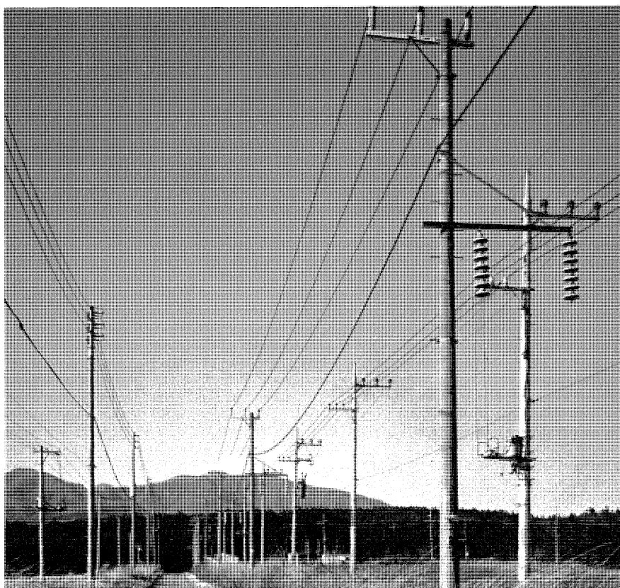
赤城試験センター実験用配電線
