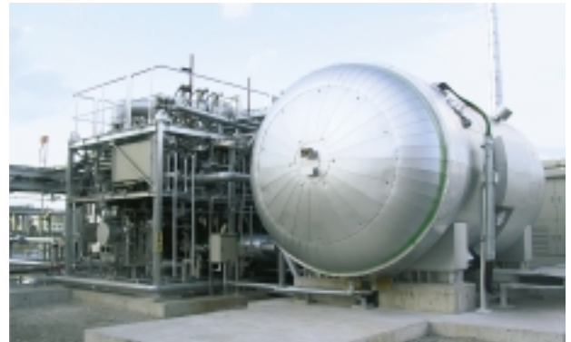
図5-1-1 300kW級MCFC発電設備
