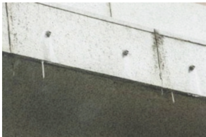
写真1 コンクリートつらら
