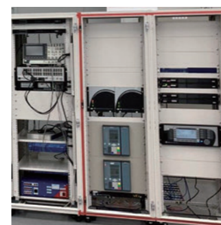
IEC 61850 適用変電所検証設備
