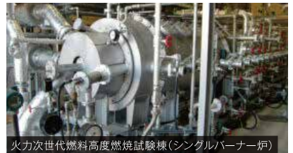
火力次世代燃料高度燃焼試験棟(シングルバーナー炉)
