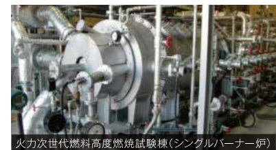
火力次世代燃料高度燃焼試験棟(シングルバーナー炉)
