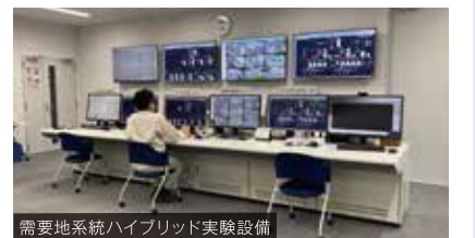
需要地系統ハイブリッド実験設備
