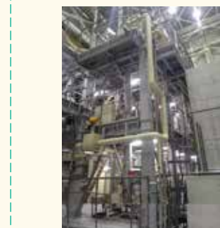
軽水炉三次元熱流動実験設備
