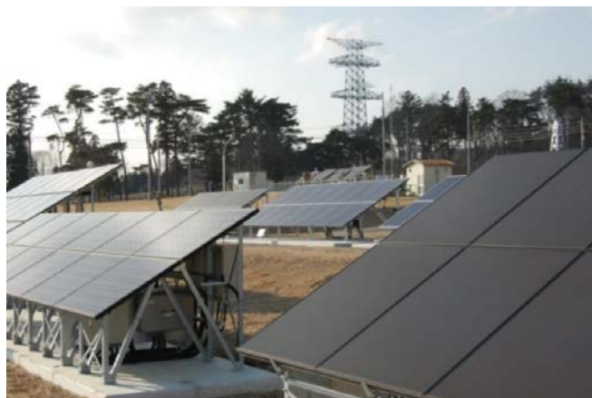
図-7 赤城試験センターに設置した太陽光発電の屋外計測サイト
