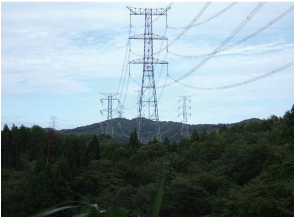
送電用鉄塔の外観
