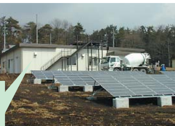
わが国唯一の設備「需要地系統ハイブリッド実験設備」
