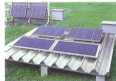
工場屋根への設置例
