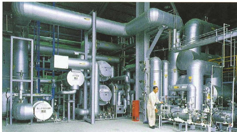
100kW級の試験装置（MCFC発電システム技術研究組合）
