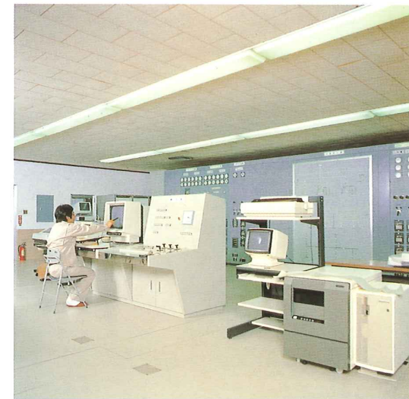
配電自動化実験設備（制御棟）
