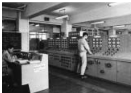
送電システムの異常電圧など回路現象を実験研究する交流模擬送電線設備 (S33年)
