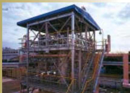
超重質油系燃料のガス化技術研究炉(H12年)
