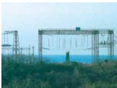
500kV課電ばく露実験場 (S46年)
