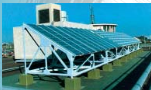
狛江研究所屋上に設置した実験用太陽光電池 (S51年～)
