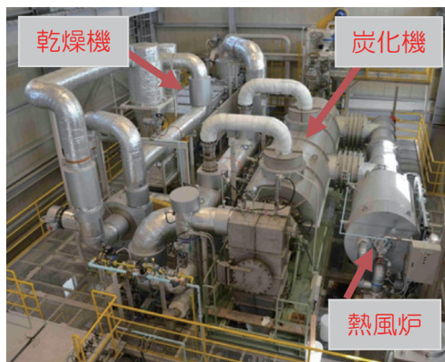
設備全体の様子
