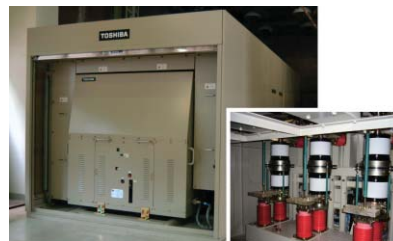
保護遮断器システム
