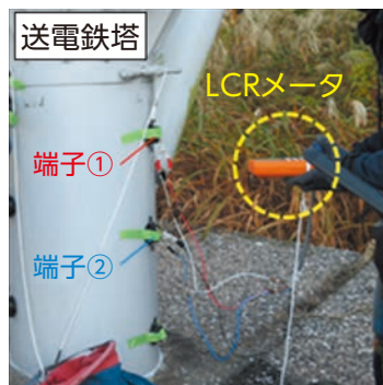
実際の送電用鉄塔での塗膜劣化診断の様子と赤城試験センターの大気ばく露試験設備
