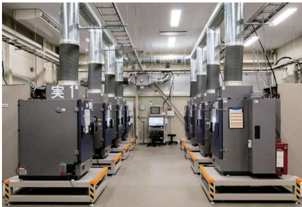
導入した充放電試験設備
