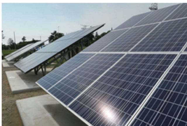
赤城試験センターの太陽光発電設備
