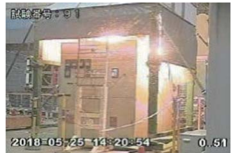
内部アーク試験 電気盤の内部にてアーク放電を発生させ、HEAF火災に至る条件を把握しました。
